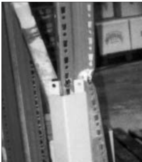
Ryc. 28. Przykład poważnego uszkodzenia słupa na wysokości około 1m nad posadzką. Regał był "normalnie" używany
