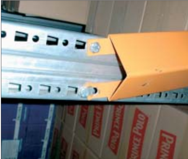
Rys. 4. Trwale uszkodzona odbojnica mocowana bezpośrednio na słupie regału. Źródło: Fot. Constructa Plus
