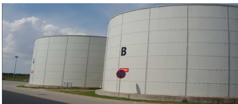
Fot.11. Zbiorniki z wodą
