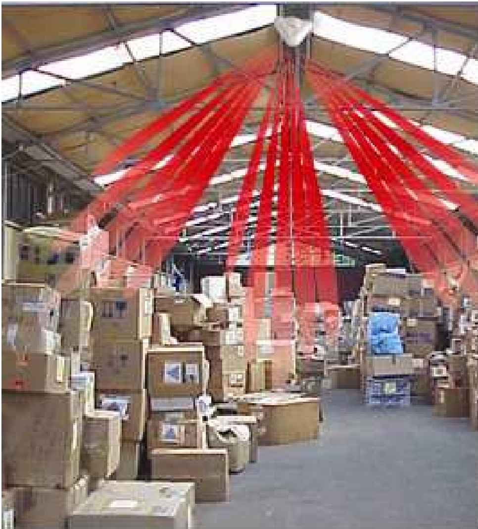
Rys. 3. Przykład zastosowania czujki magistralowej sufitowej w magazynie
