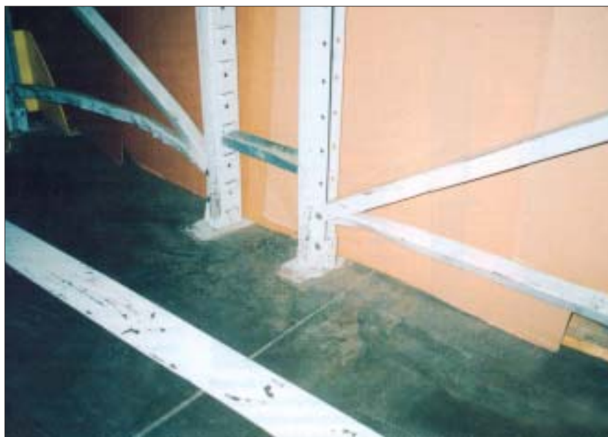
Fot. 2. Odkształcony już podczas montażu słup przedni regału ramowego paletowego wolno stojącego oraz odkształcona podczas eksploatacji odbojnica czołowa osłaniająca słupy (Fot. A. Wojciechowski)
