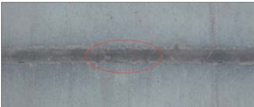
Rys. 5. Wypełnienie dylatacji niezwiązane z podłożem.
