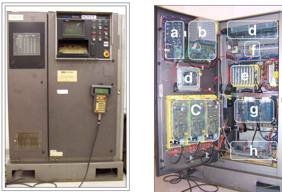
Rys. 4. Kontrolera typu R-H robotów Fanuc a) CRT/KB; b) Panel operatora; c) Serwomechanizmy; d) Chłodzenie e) System wejść i wyjść; f) Układy bezpieczeństwa; g) Komputer; h) Zasilanie
