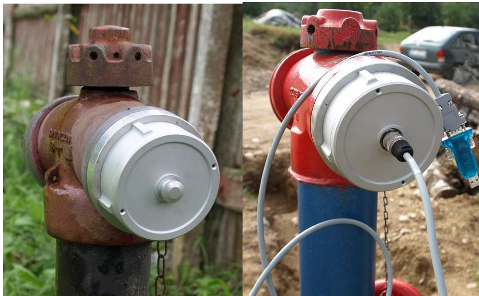
Rys.1. Rejestrator pomiarów ciśnienia wody Biatel Cellbox HN, zamontowany w hydrancie nadziemnym
