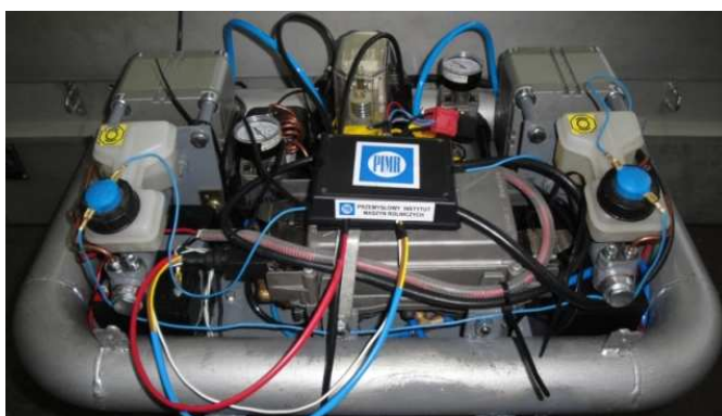
Rys. 5. Model doświadczalny (11-2009) układu hamulcowego PIMR zamontowany w przyczepie, na pierwszym planie - zbiornik sprężonego powietrza
