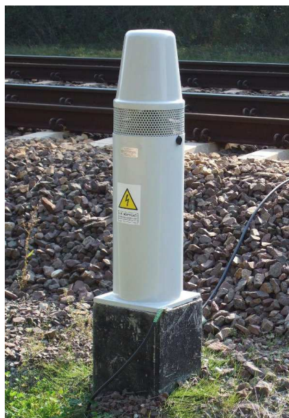
Fot. 5. Urządzenie akustyczne zamontowane na odcinku Mińsk Mazowiecki – Siedlce [15]
