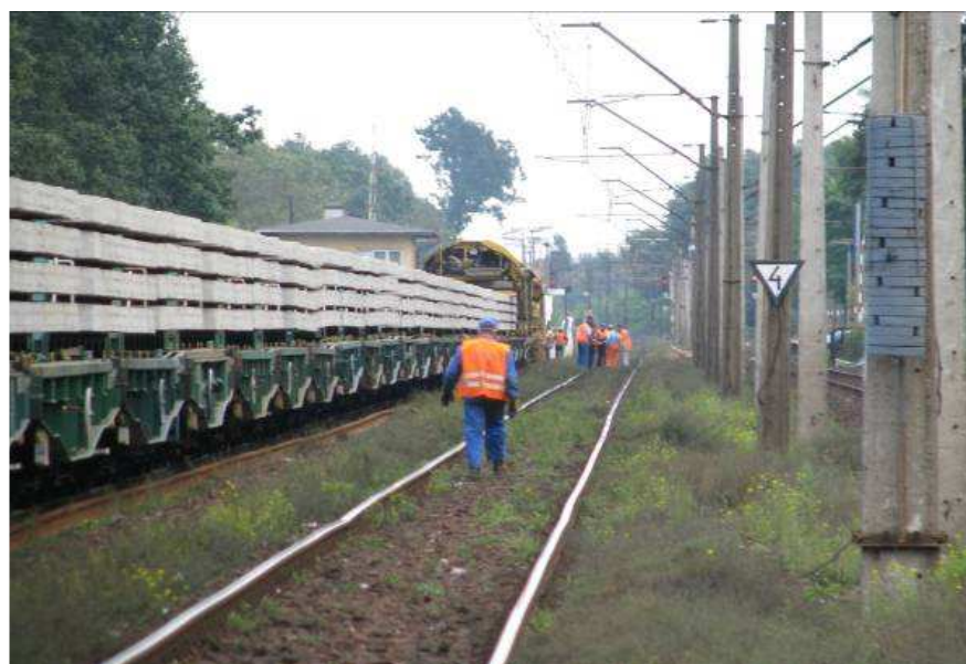
Rys. 5 Wagonami typu 401Z do obsługi PUN-a
