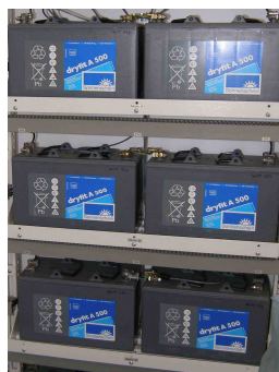
Rys. 2. Baterie akumulatorów kwasowo-ołowiowych
