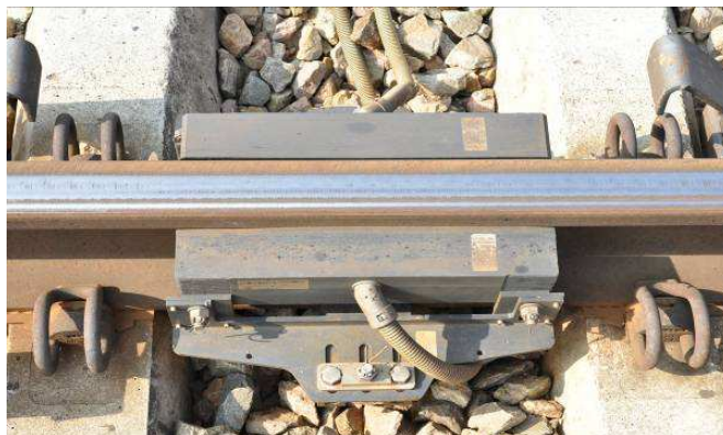
Rys. 10 Licznik osi SOL-21 w miejsce klasycznych styków izolowanych klejno-sprężonych [źródło: opracowanie własne]
