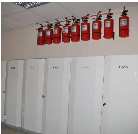
Rys. 9 Pomieszczenie serwerowi LCS Nasielsk [źródło: opracowanie własne]
