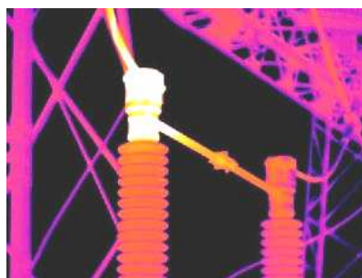
Rys.6 Przegrzany styk obrotowy odłącznika
