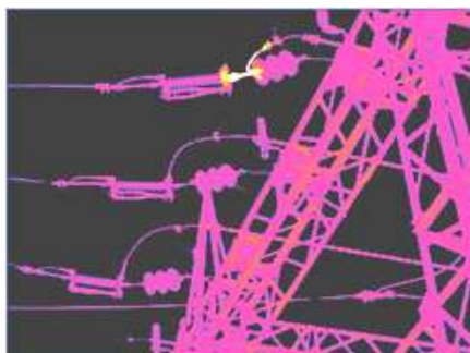
Rys.10 Wadliwe połączenie zacisków prasowanych na uchwycie odciągowym
