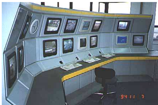
Rys. 6 Widok Centrum monitorowania systemów R.B.TEC
