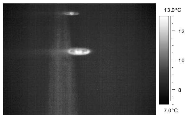
Rys. 7. Zdjęcie termowizyjne żle zamocowanego agregatu – obok wzmocnienia [1]
