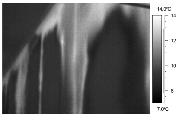
Rys. 10. Zdjęcie termowizyjne niezabezpieczonego uszkodzenia poszycia [1].
