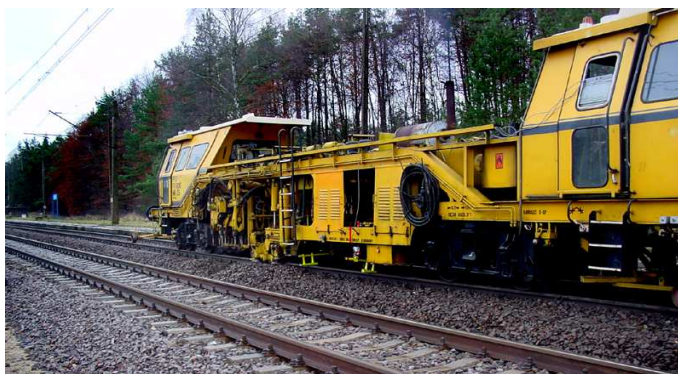
Rys. 1. Automatyczna podbijarka torowa z zamontowanymi czujnikami pomiarowymi
