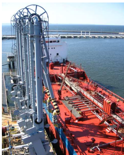
Rys.5. Portowe ramiona przeładunkowe podłączone do instalacji statkowej.
