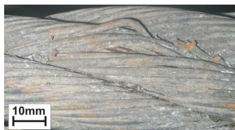
Rys. 4. Deformacje splotek oraz pęknięte druty w jednej ze splotek
