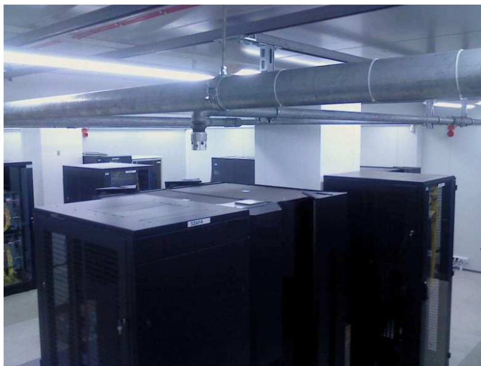
Rys. 8. Rurarz podsufitowy systemu gaszenia gazem na serwerowni
