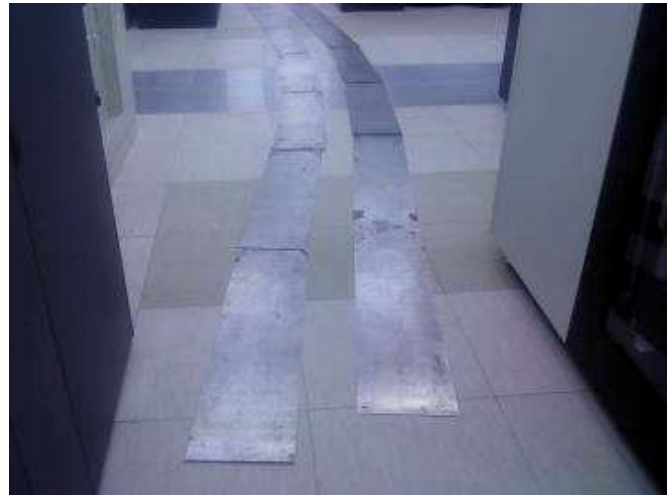
Rys. 4. Przejazd przez kratki nawiewowe
