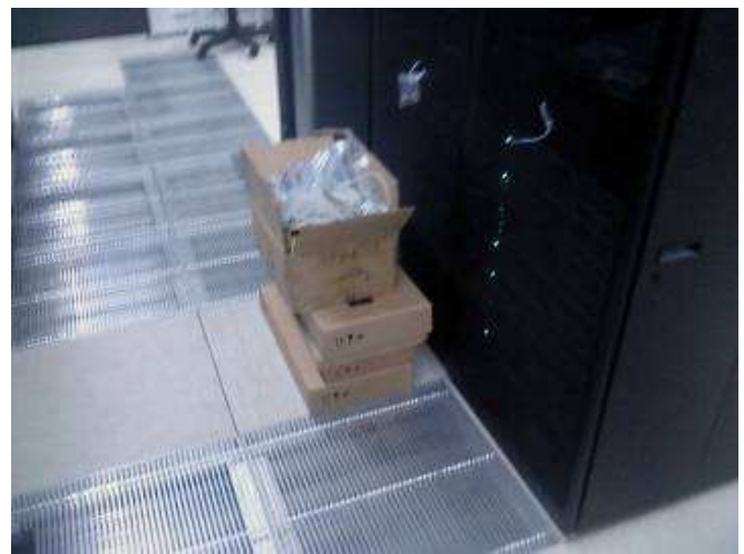
Rys. 6. Przejazd przez kratki nawiewowe
